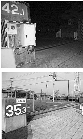
防潮扉閉鎖の様子
